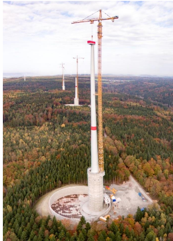
Abbildung 3: Eine der Windkraftanlagen im Aufbau. Foto: © Max Bögl Wind AG, Fotograf: Holger Heschenthaler.
